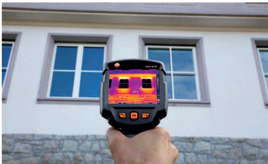
testo 872s – Külső szigetelés termográfiai vizsgálata
