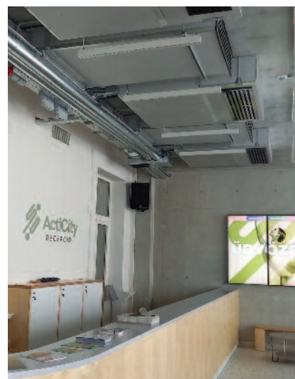
3. kép – Látszó fan-coil berendezések
