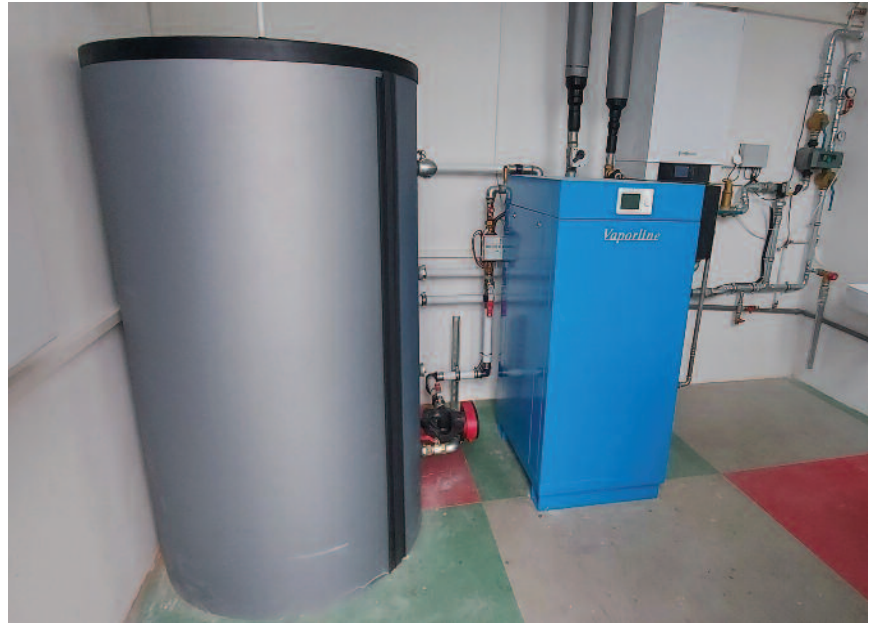
2. kép – Hőközpontba beépített Vaporline® GWT hőszivattyú
