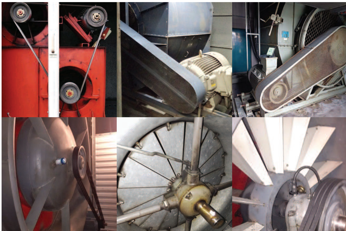
Felújításra szoruló, öreg ventilátorok
